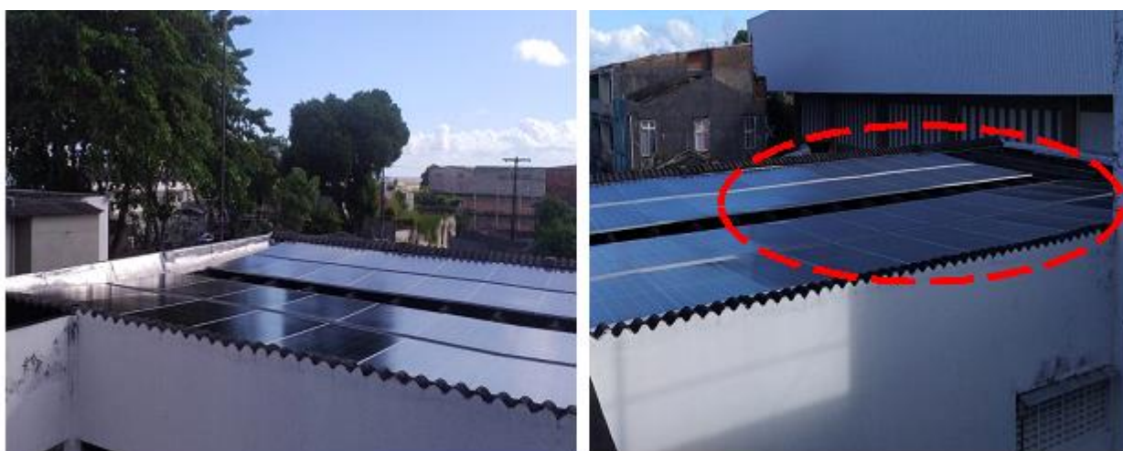
Figura 8: “a” e “b” – Visão do telhado do anexo do bloco “O”
